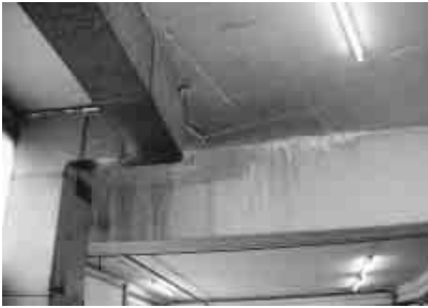
Die wirklichen Schäden sind bereits geschehen, auf dem Dach!
